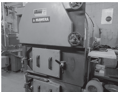
Heizungsanlage im Frödtschsaal
